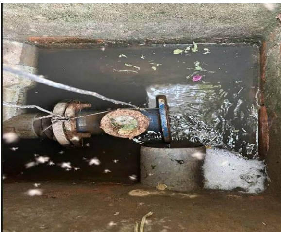
Vị trí lắp đặt đồng hồ đo lưu lượng nước thải đầu ra của hệ thống
