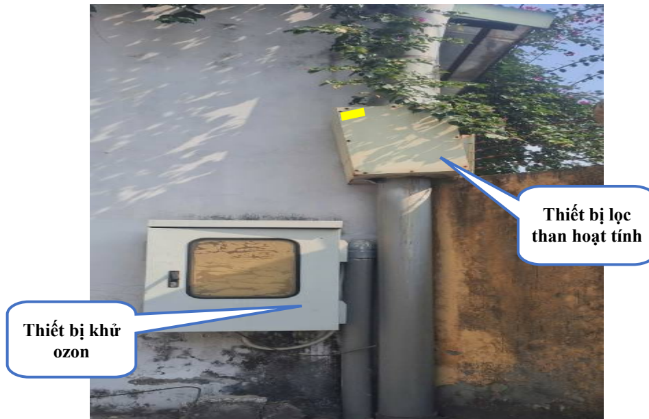
Hình 3.15. Hiện trạng hệ thống xử lý khí thải tại cơ sở
